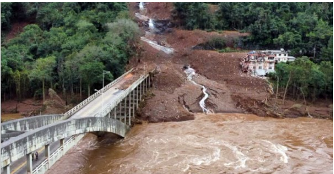
Ponte Ernesto Dornelles teve a cabeceira destruída durante a enchente
